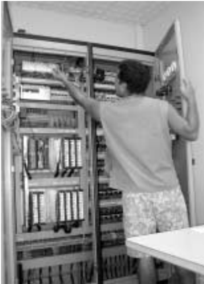
Cette armoire électrique abrite la liaison par fibre optique reliant la télécommande des contrôleurs aux nouveaux régulateurs.
