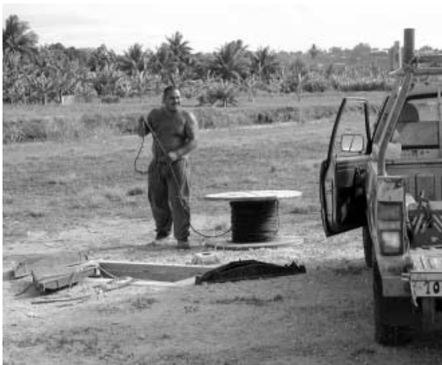
Le tirage de câbles d'une chambre en béton à l'autre représente un travail de longue haleine.
