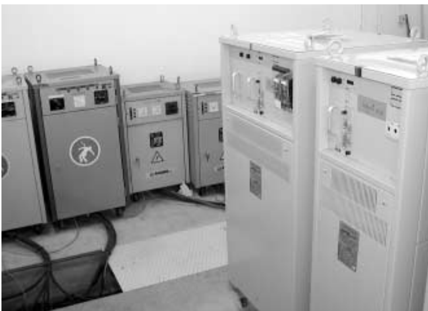
Les anciens régulateurs (à gauche) fonctionnent toujours, mais ils ont dû laisser place à leurs successeurs (à droite).
